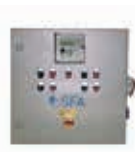
Caja de control PS2
